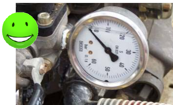
Fig. 33 – Esempio di manometro nuovo con intervallo di lettura (1 bar) e fondo scala (60 bar) adeguati .
