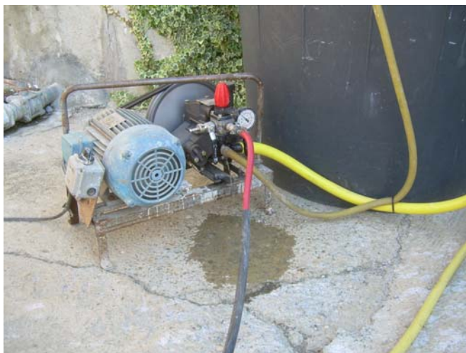
Fig. 40 – Esempio di intervento (gocciolamento tubazioni) al quale si è posto rimedio direttamente durante il controllo funzionale.
